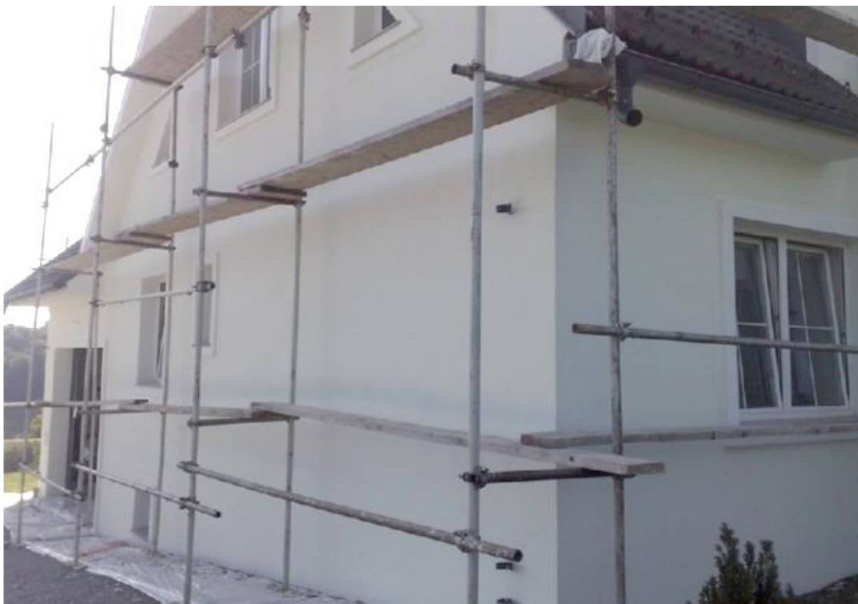
Slika 20: Prikaz napačno postavljenega delovnega cevnega odra, zaradi manjkajočih zaščitnih ograj
