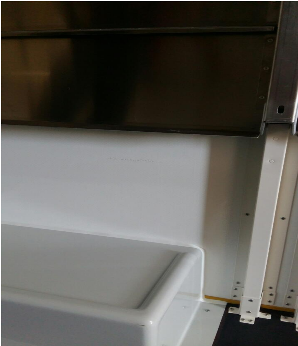
Slika 9: Nepravilna namestitvev police je poškodovala steno
