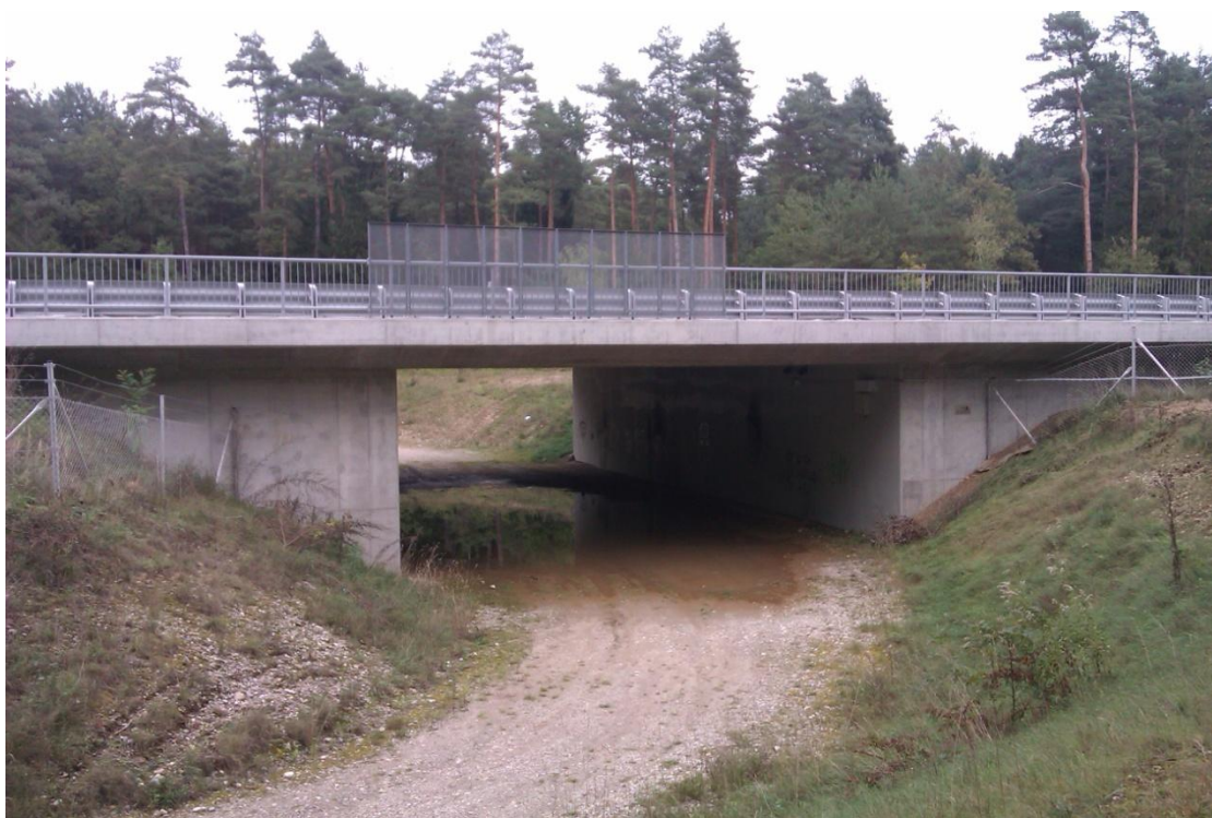
Slika 15: Zadrževanje vode pod objektom
