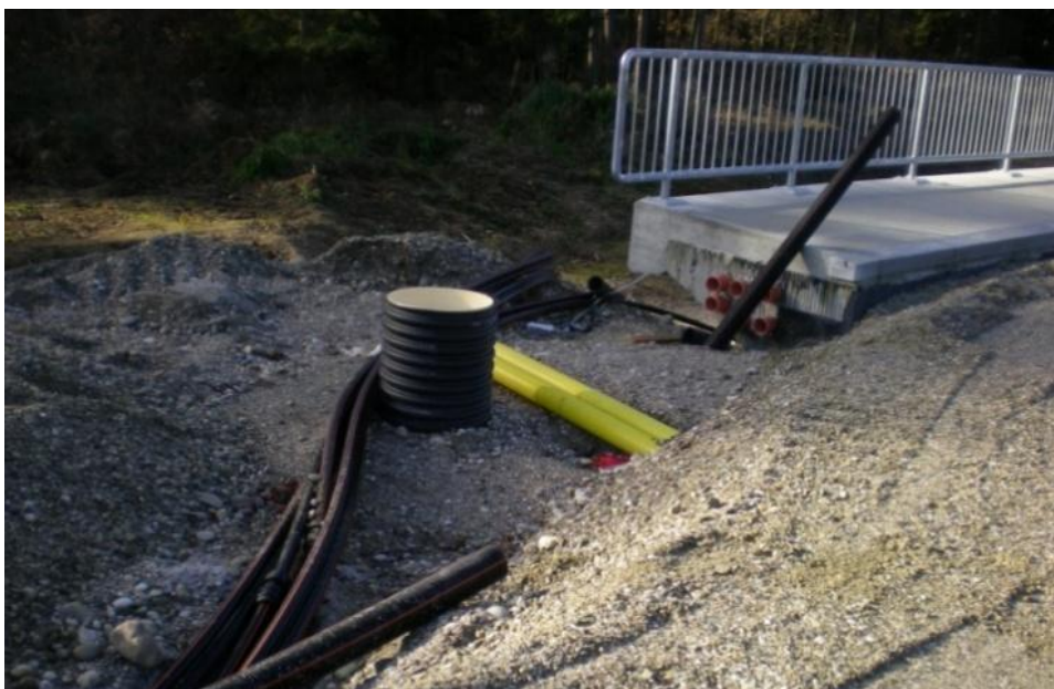
Slika 2: Inštalacije v robnem vencu
