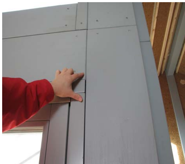
Slika 18: uhajanje zraka skozi zgornji desni vogal drsnih vrat, zaradi slabo nameščenih tesnil
