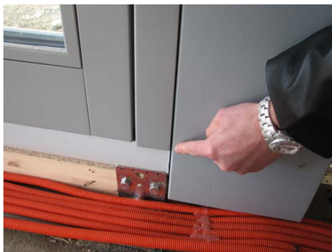
Slika 19: Uhajanje zraka skozi spodnji desni vogal vrat zaradi slabo nameščenih tesnil
