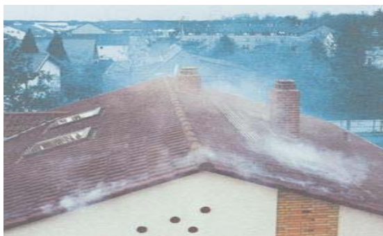
Slika 9: Uhajanje pare oziroma dima skozi slabo izolirano in ne zrakotesno streho
