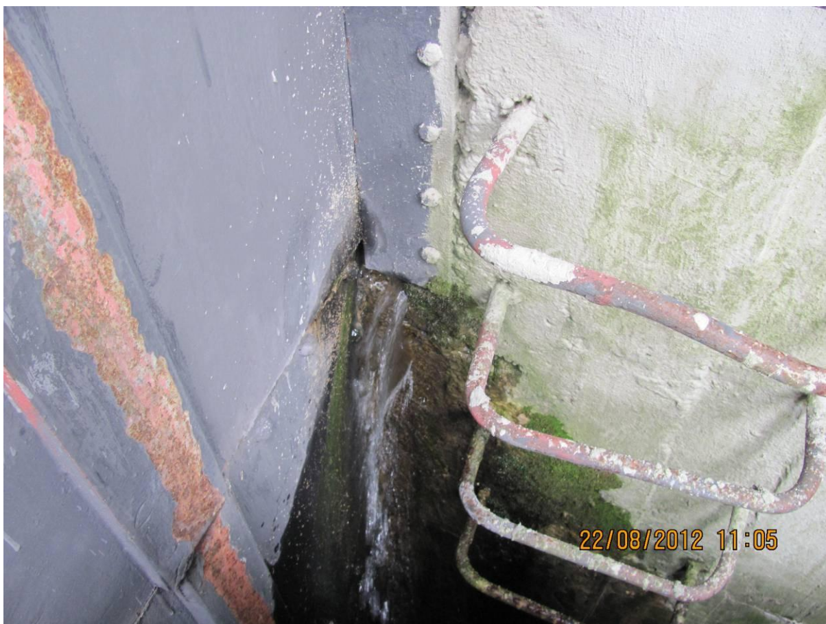
Slika 20: Primer poroznosti betonske konstrukcije (potrebna sanacija razpoke v betonu)
