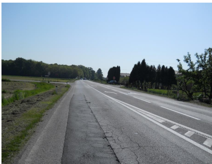
Slika 21: Poškodbe vozišča na GPS, nekvalitetne sanacije
