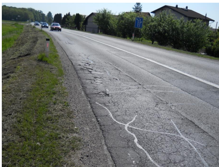
Slika 20: Razpoke na vozišču GPS in poškodbe roba vozišča
