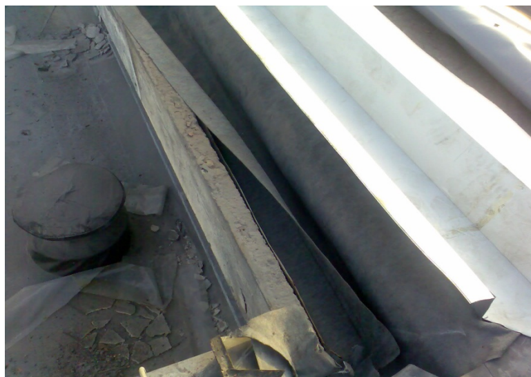
Slika 17: Neustrezna izvedba žlote. Najprimernejša je uporaba plastificirane pločevine, na katero se vari folija
