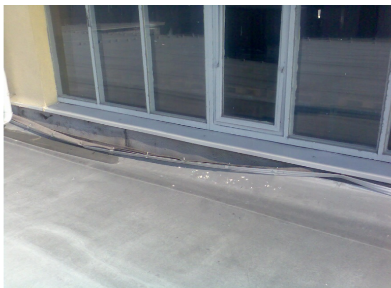
Slika 18: Detajl zidne obrobe. Pritrjevanje folije ob zidu je nezadostno. Sidra so izpuljena ali potrgana
