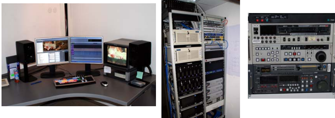
Slika 13: Montažni sklop nelinearne montaže - Nelinearna računalniška montaža Avid Adrenaline in magnetoskopi (Betacam SP in DVCPRO); vir: lasten
