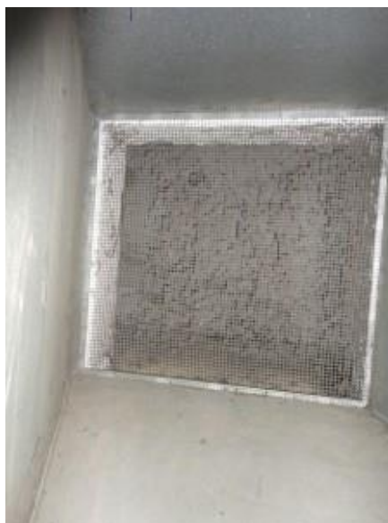
Slika 1: Primer umazanih filtrov pred čiščenjem
