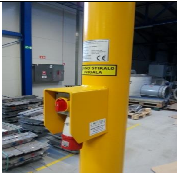
Na stebru dvigala nameščeno glavno stikalo za zaklepanje
