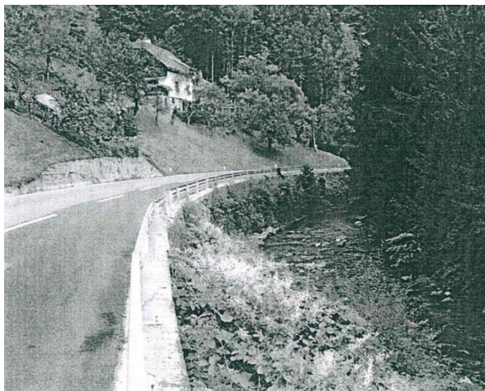
Slika 11: Dotrajan oporni zid, ki se je porušil (levo ob cestišču)
