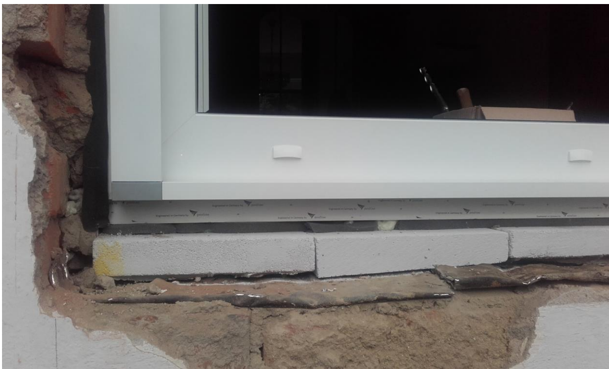
Slika 6: Zamenjava stavbnega pohištva z nepravilno RAL-montažo
