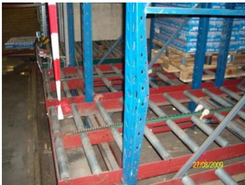
Slika 3: Poškodba regalnega elementa
