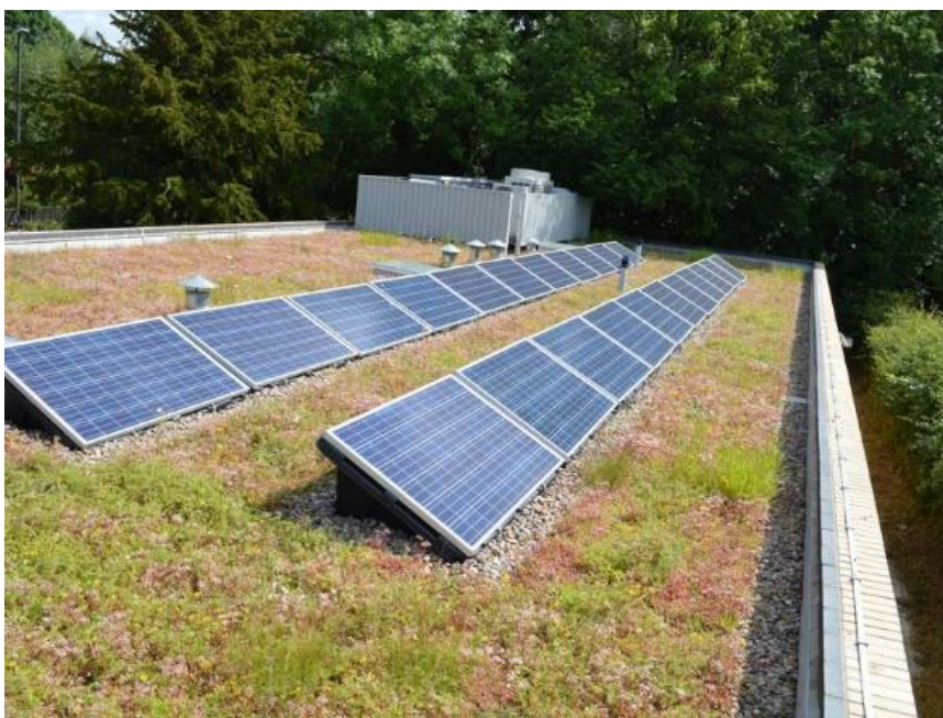
Slika 24: Končana Solarbase 30 zelena streha
