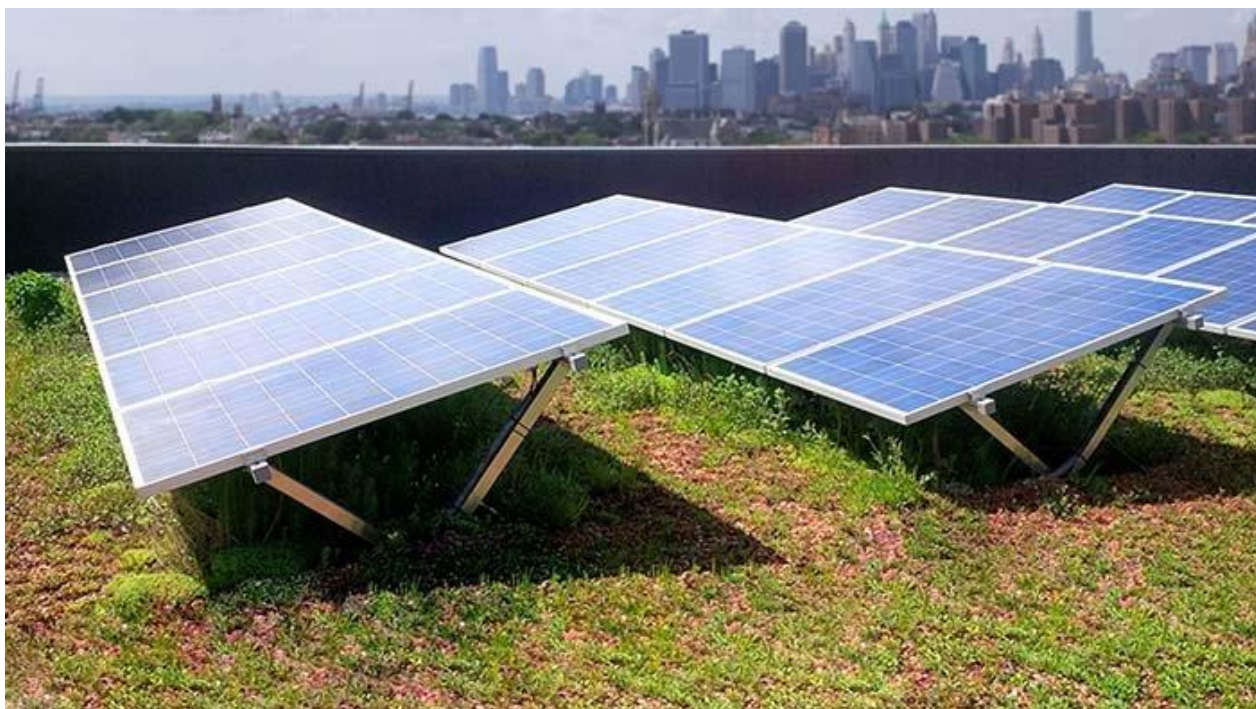
Slika 16: Integriran sistem PV-panelov in zelene strehe v New Yorku
