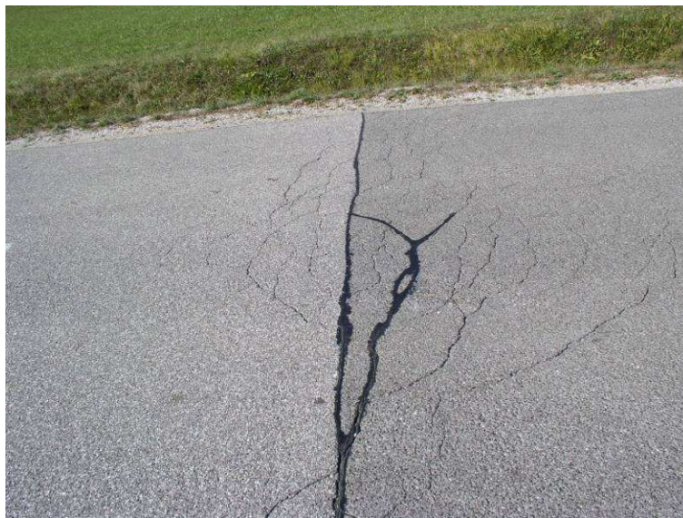
Slika 17: Primer sanirane razpoke
