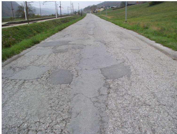
Slika 2: Primer utrujenosti asfaltne plasti
