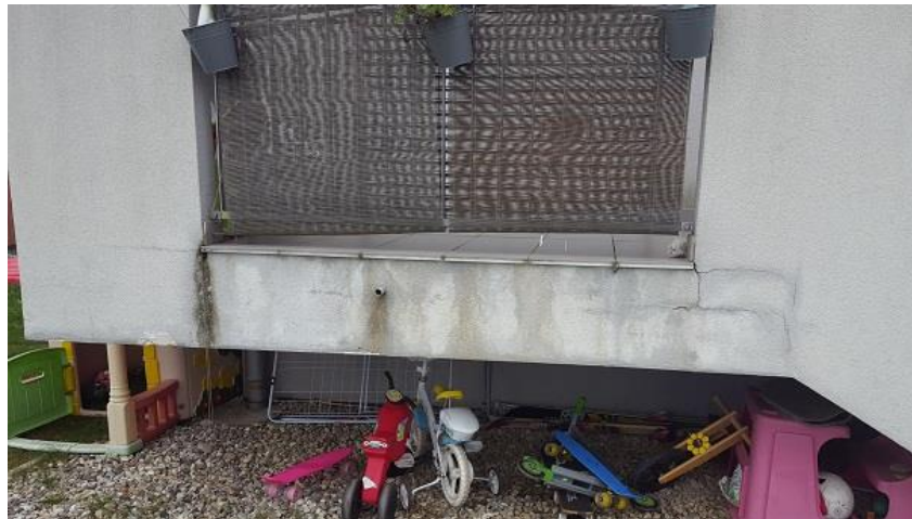
Slika 9: Prikaz razpokanosti fasade v predelu AB plošče - balkon /terasa - sledi stekanja meteorne vode, prisotnost alg
