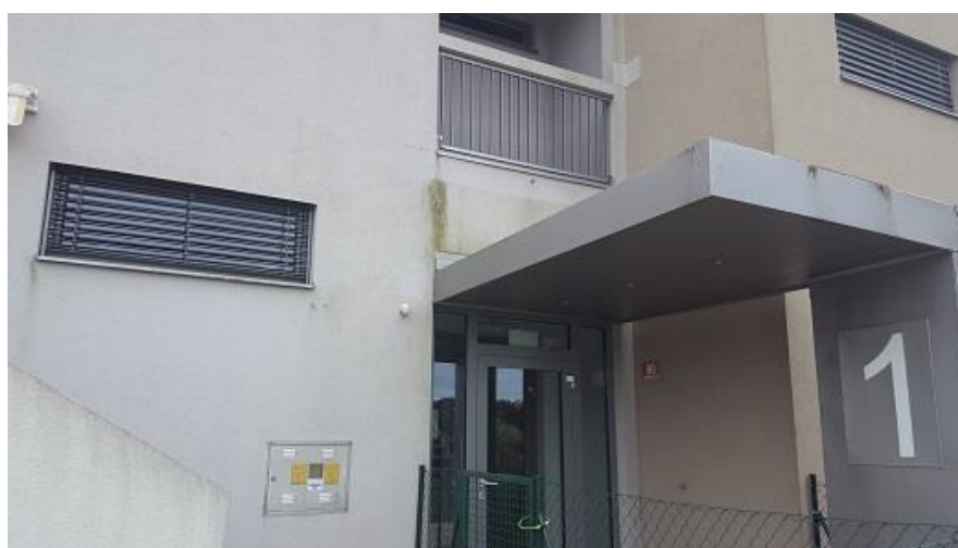
Slika 12: Sledi plesni in alg pod balkonom in nad vhodom v objekt
