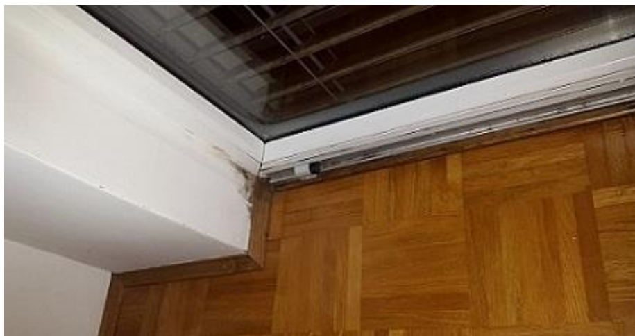
Slika 6: Pojav plesni, kot posledice toplotnega mostu
