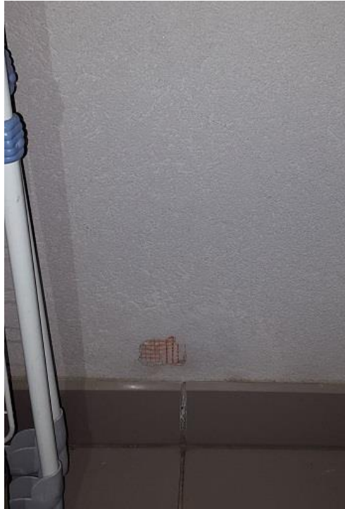
Slika 14: Odstopanje zaključnega sloja
