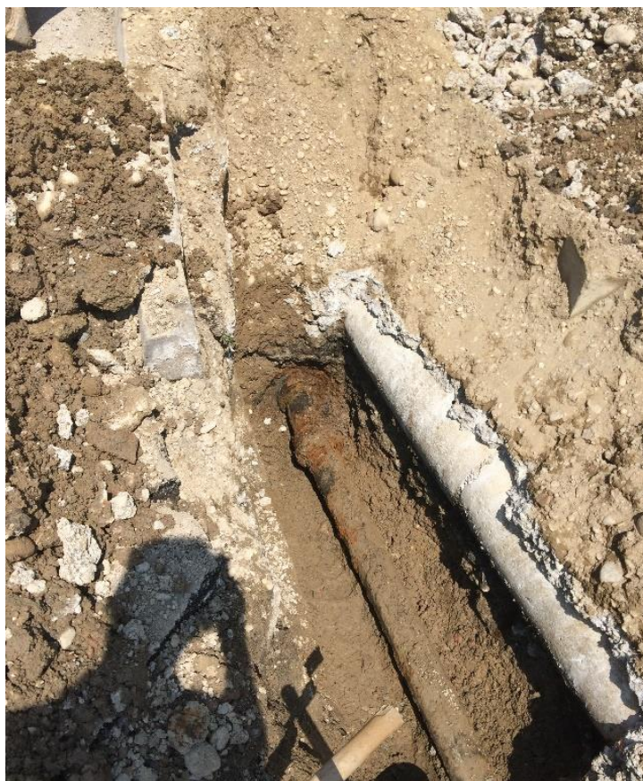
Slika 16: Defekt na starem cevovodu (popustil spoj)
