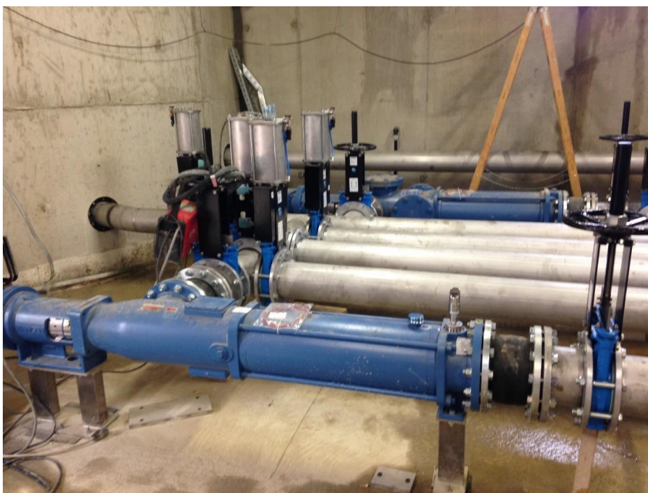
Slika 7: Črpalke substrata, ročni in pnevmatski ventili
