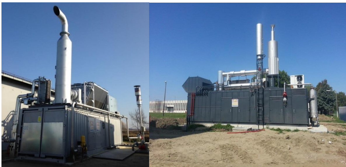
Slika 11: Kogeneracija s plinsko baklo
