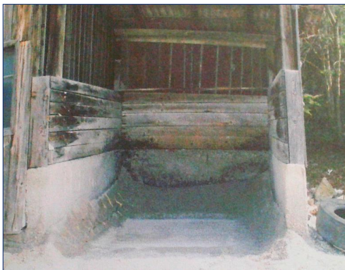
Slika 10: Lesena uta za skladiščenje zmesi zrn za posipanje vozišča
