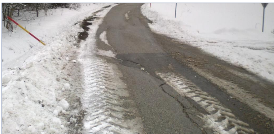
Slika 16: Razpoke na cestišču
