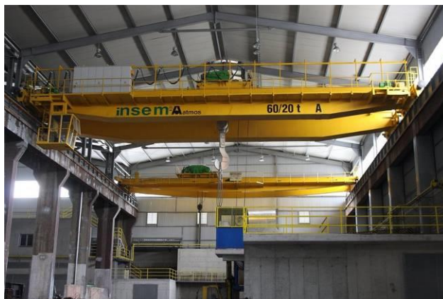
Slika 22: Mostni žerjav v proizvodnji
