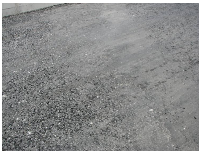
Slika 20: Nehomogena površina asfaltne plasti
