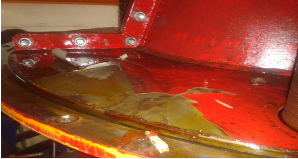
Slika 29: Prikaz luščenja barve v notranjosti ohišja nosilnega ležaja
