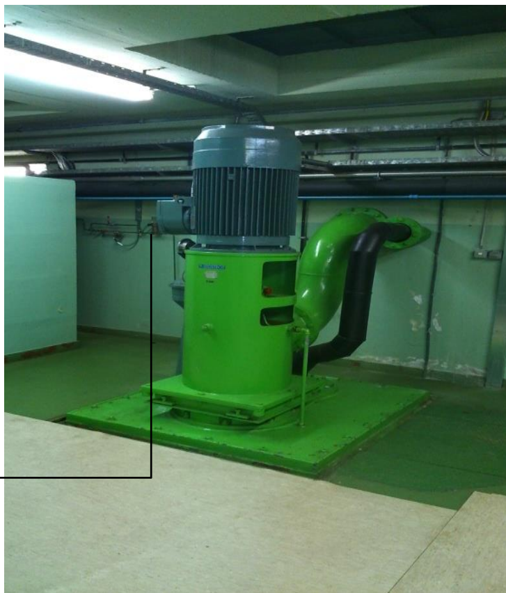
Slika 14: Glavna črpalka drenaže turbinskega stebra Vir: Lasten
