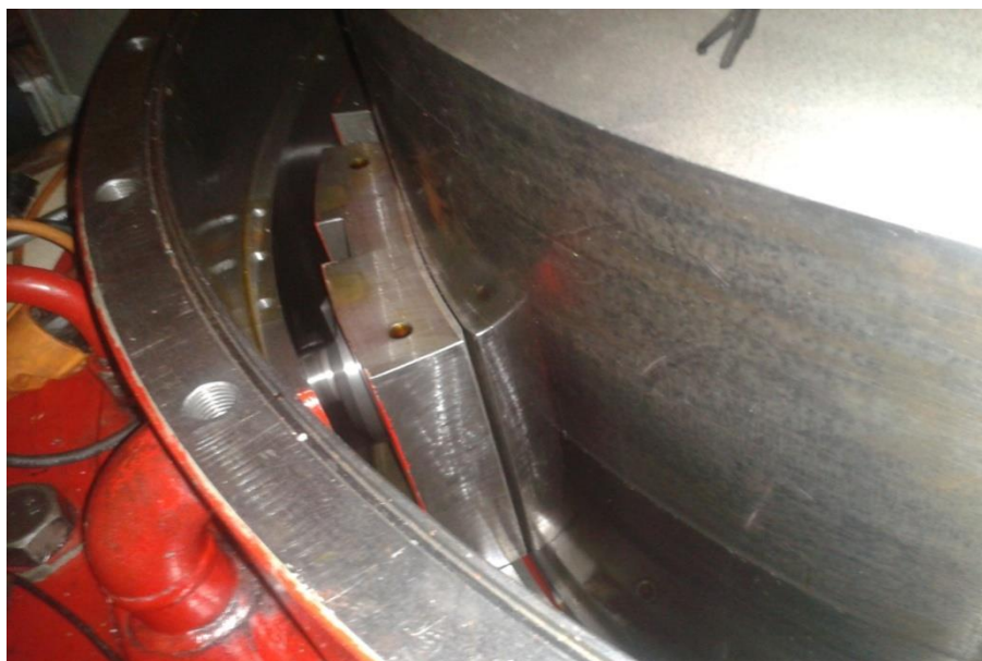
Slika 27: Turbinska gred in segment turbinskega ležaja
