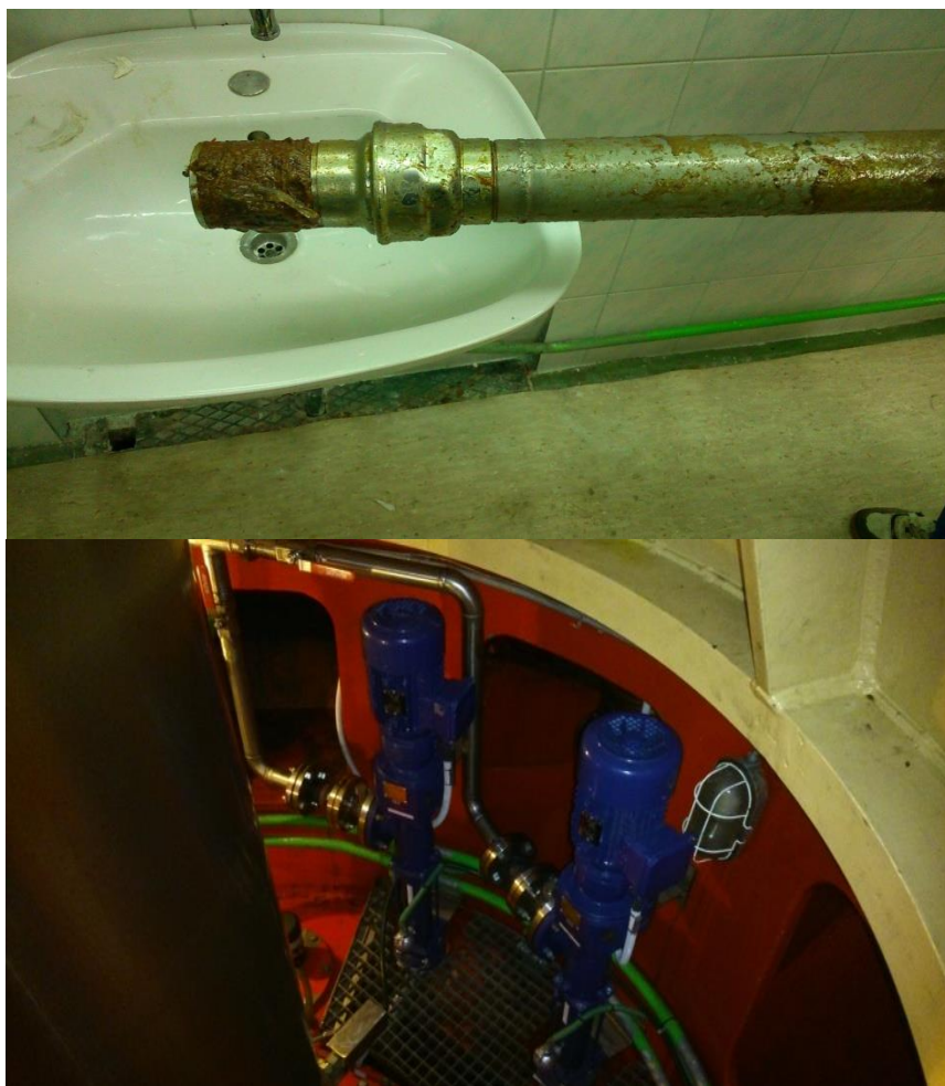
Slika 18: Zamašen koš in črpalka drenaže turbinskega pokrova ter zamašen koš črpalke
