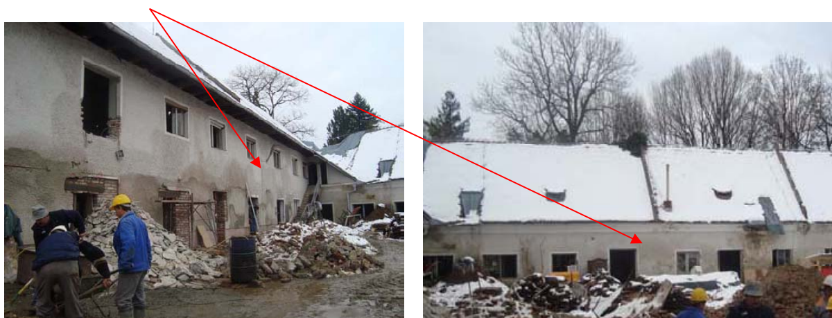
Slika 17: Vidna vlaga na zunanosti zidov v pritličju in nadstropju objekta
