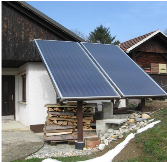
Slika 11: Vgrajeni sončni kolektorji
