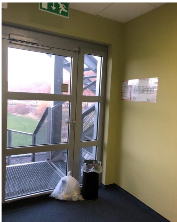
Slika 5: Požarne stopnice na hodniku vsakega nadstropja
