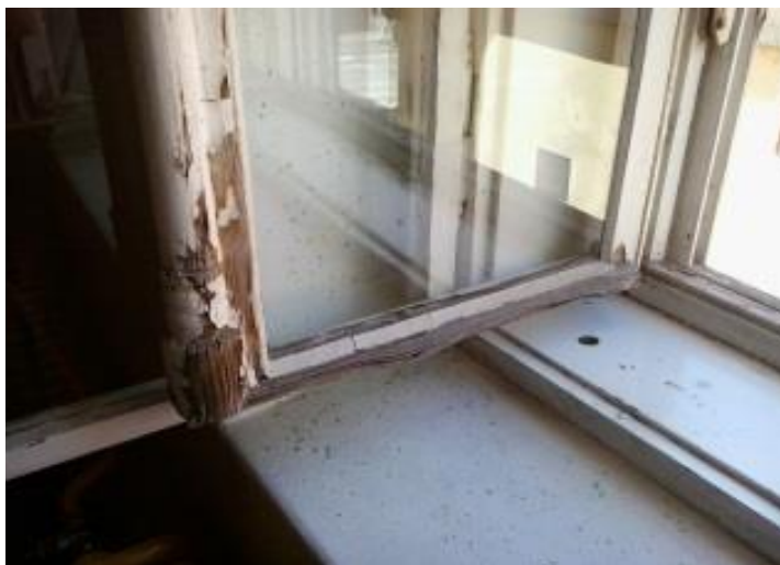
Slika 11: Staro razpadlo okno
