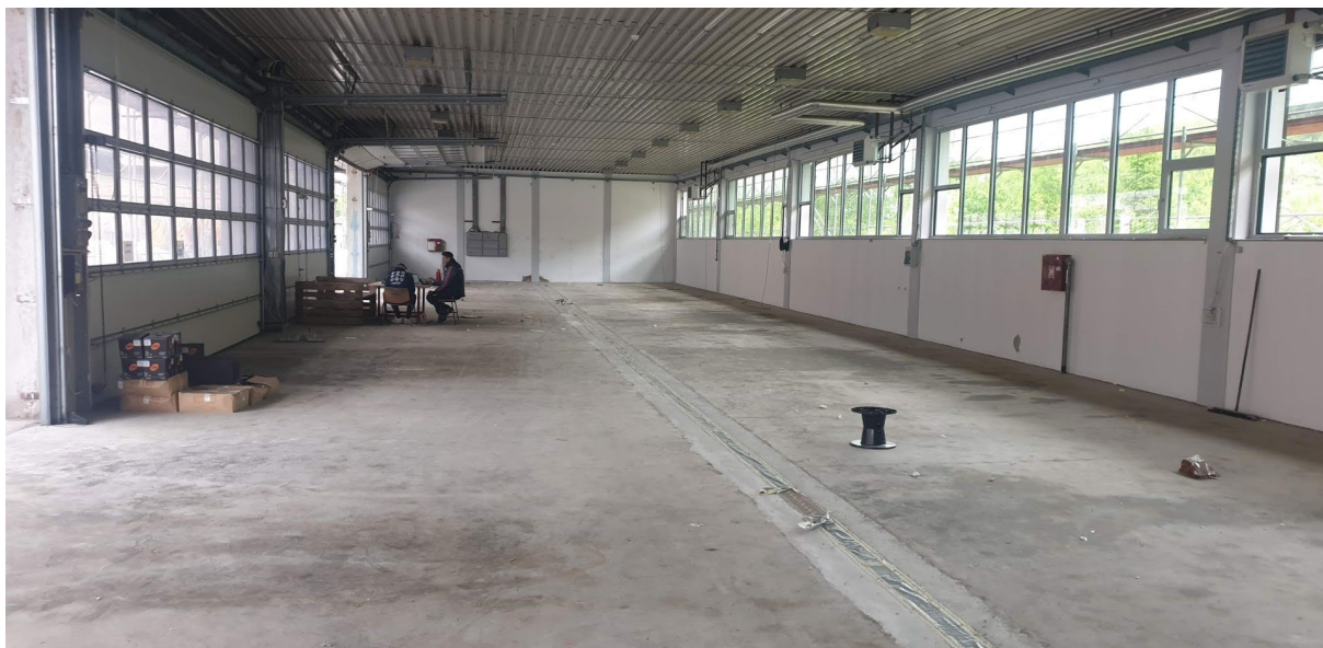
Slika 2: ACB Hrušica – stanje tlakov pred sanacijo
