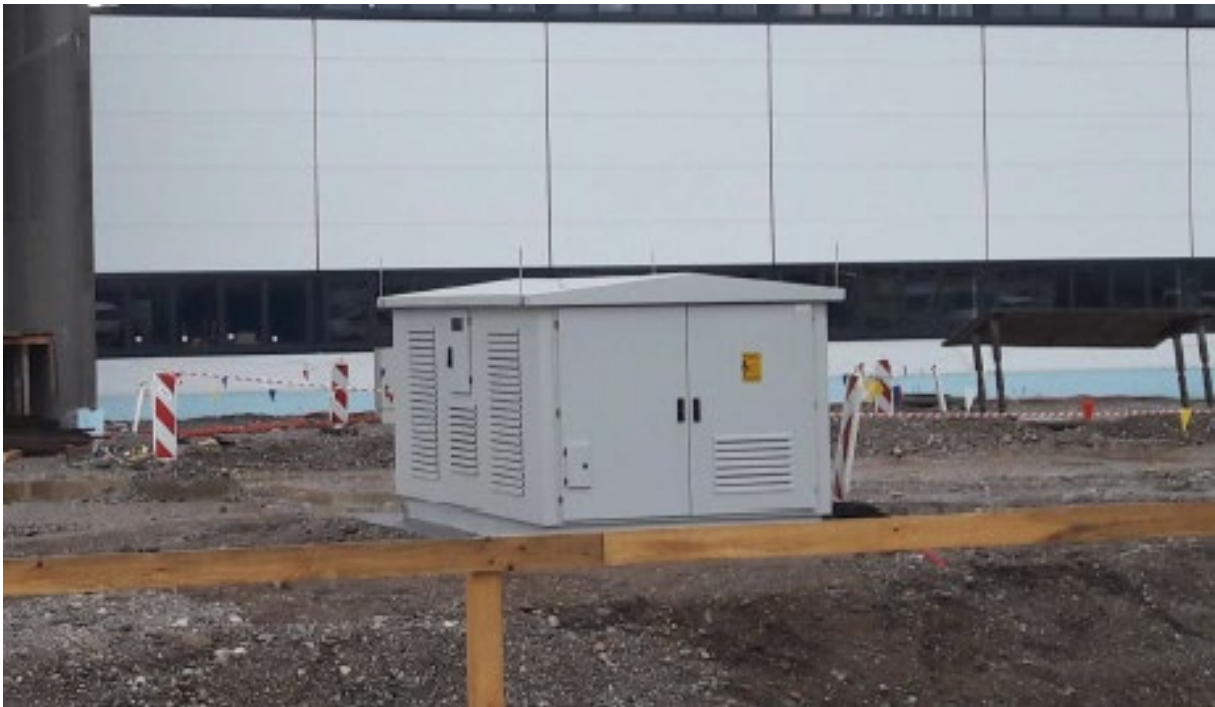
Slika 12: Transformatorska postaja na gradbišču
