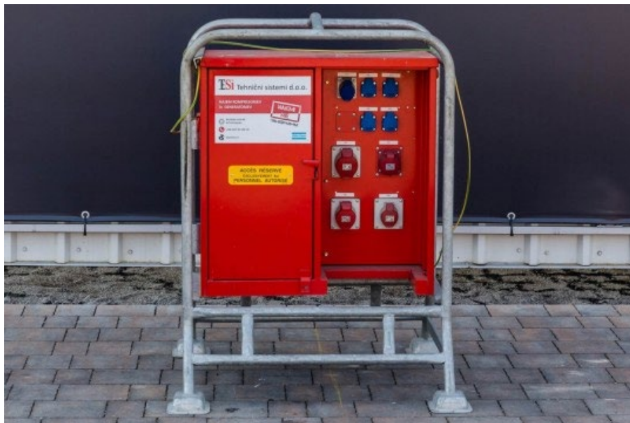
Slika 14: Gradbena priključna elektro omarica
