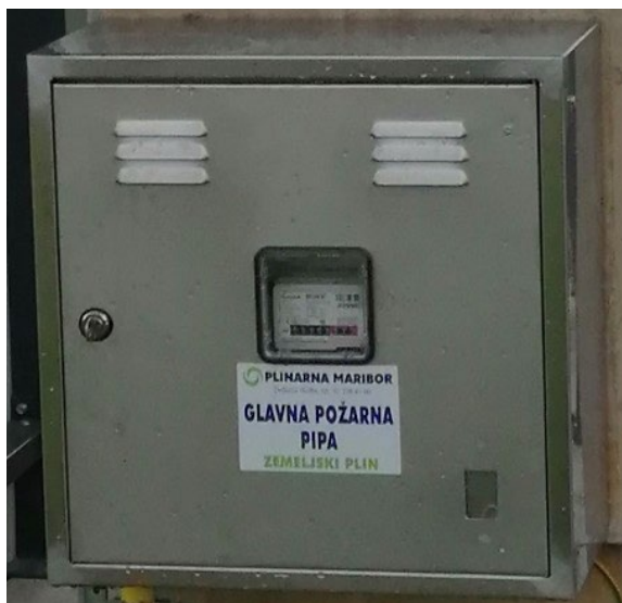
Slika 18: Plinska omarica z glavno požarno pipo
