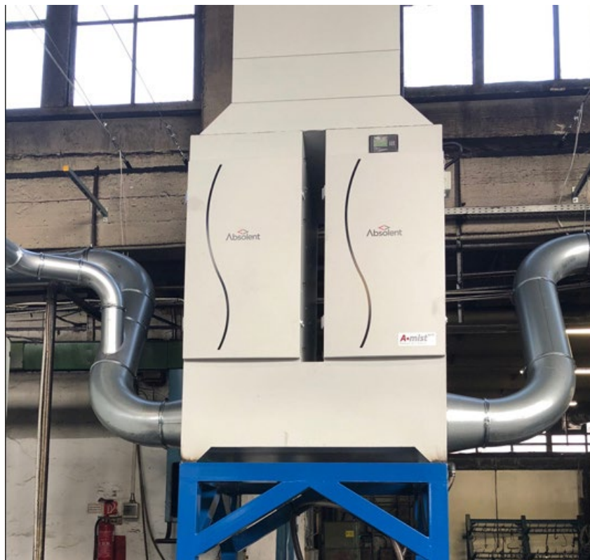
Slika 7 Centralna filtrirna enota – več strojev
