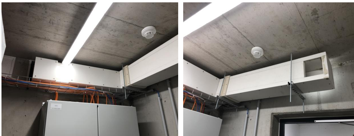
Slika 3: Prezračevalni kanal iz silikatnih plošč v poslovno-hotelskem objektu Brain@Work Center Klagenfurt Vir: (Lastni vir)
