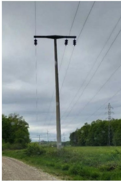
Slika 3.2: Nadzemni elektrovod DV 20 kV Črešnjevci (d-531)
