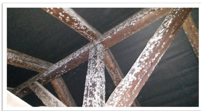
Slika 20: Poškodovano ostrešje s plesnijo
