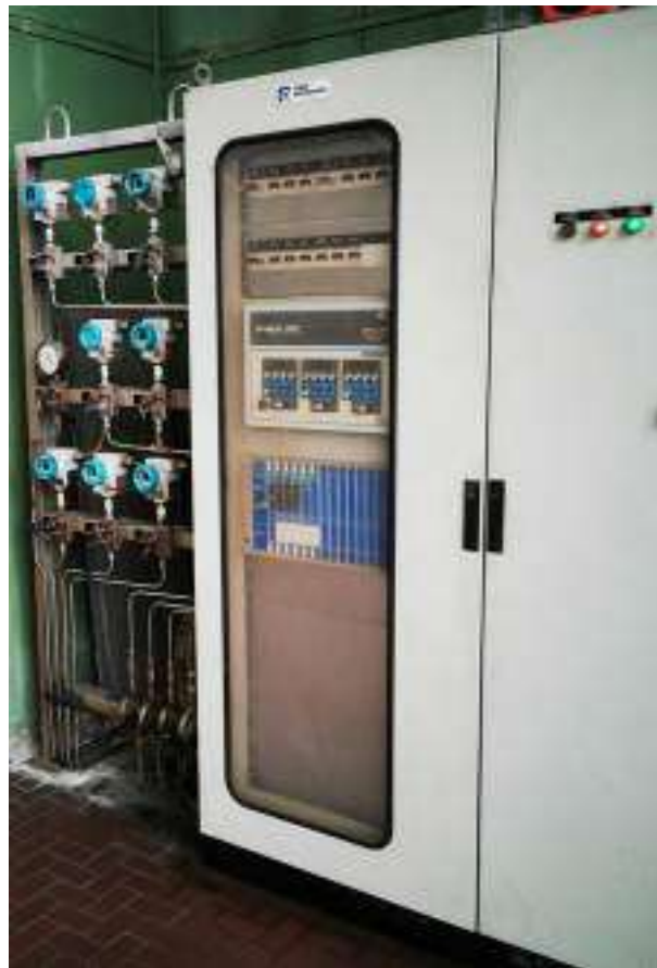
Slika 28: Panel inštrumentov in elektro omara za elektronsko zaščitno opremo
