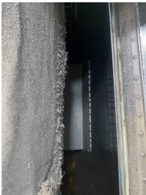
Slika 44: Jeklena plošča v ciklonu
