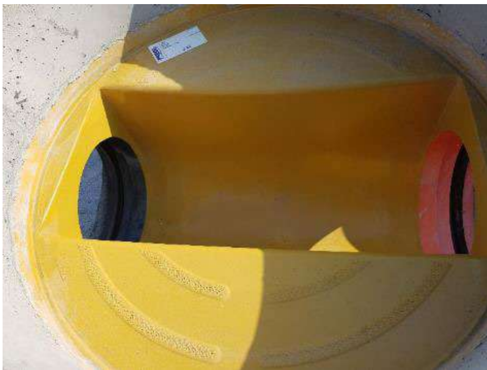
Slika 31: Lita mulda betonskega jaška
