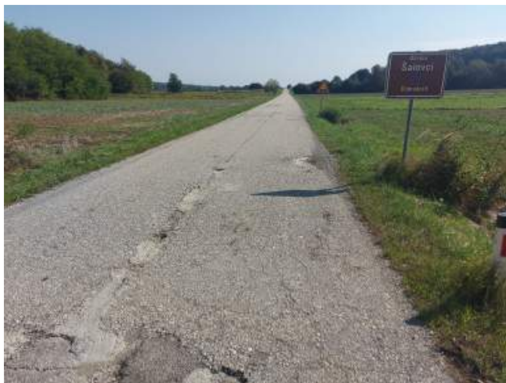
Slika 3: Stanje asfaltnega vozišča na delu občine Šalovci
