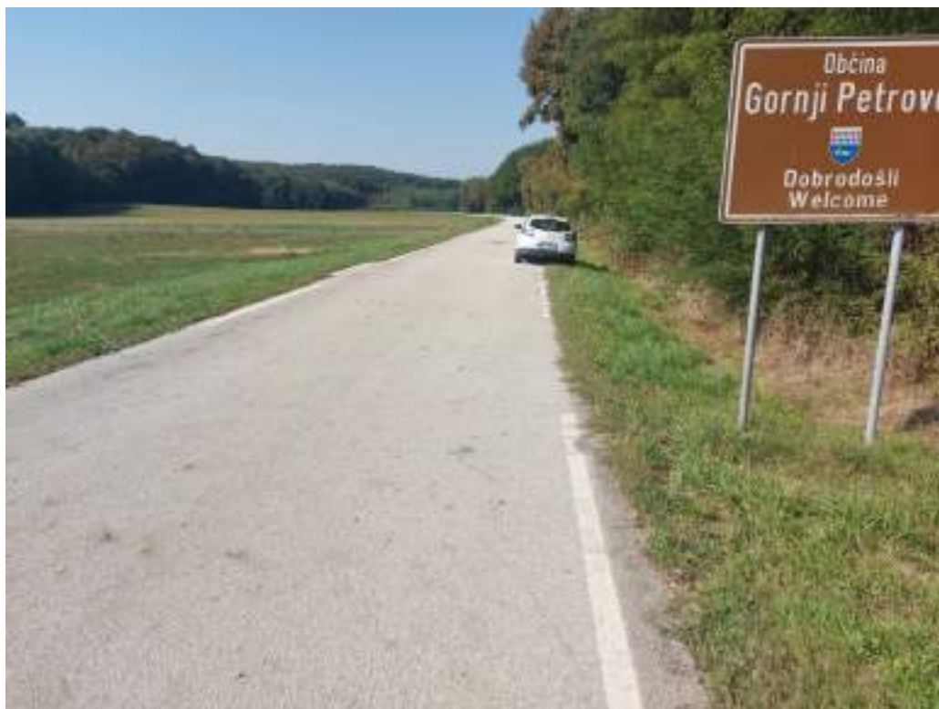
Slika 2: Stanje asfaltnega vozišča na delu občine Gornji Petrovci
