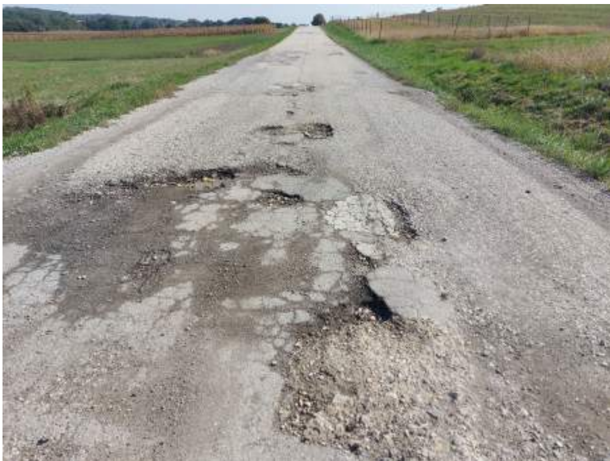
Slika 7: Stanje asfaltnega vozišča Šalovci–Adrijanci
