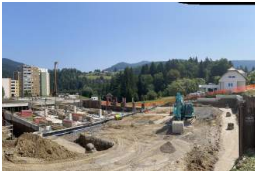
Slika 11: Fotografija odkopanih izvedenih pilotov/odbitih delov nezdravega betona pilota (nakupovalni center CP Ravne)
