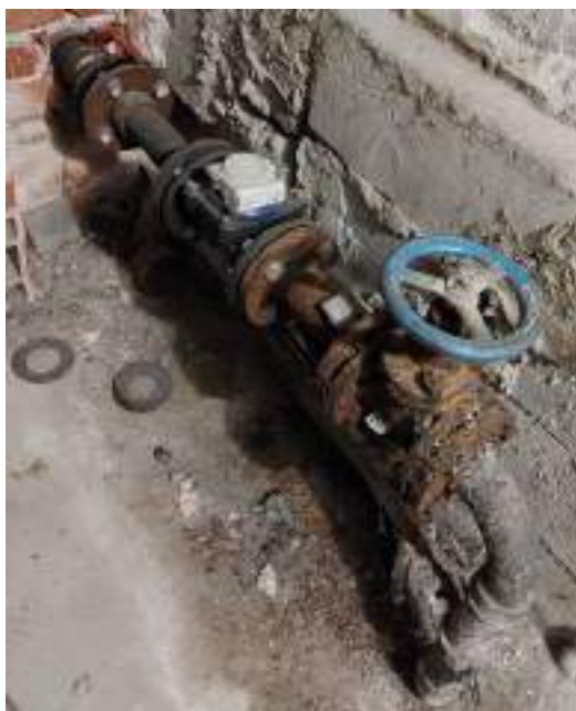
Slika 12: Lokacija in videz vodomernega merilca pred obnovo
