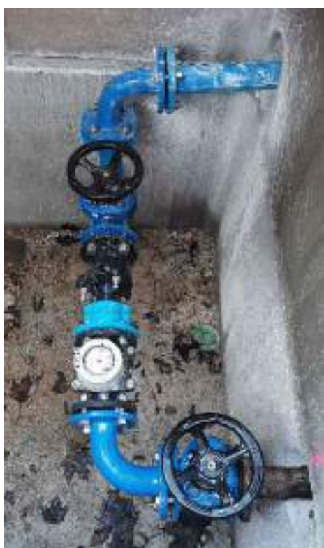
Slika 15: Vgrajeni elementi v vodomernem jašku DN50 na Čopovi ulici
