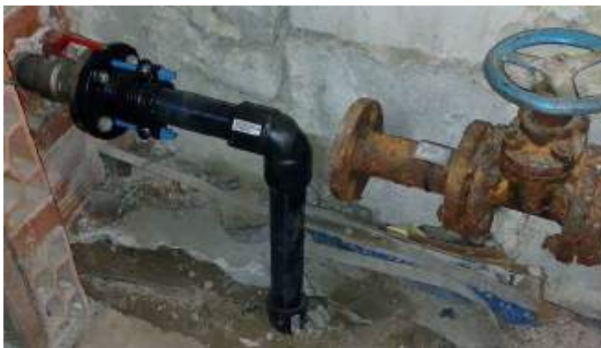
Slika 14: Hišni priključek v notranjosti objekta po obnovi
