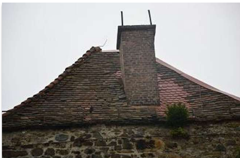
Slika 5: Dotrajana in deformirana strešna konstrukcija
