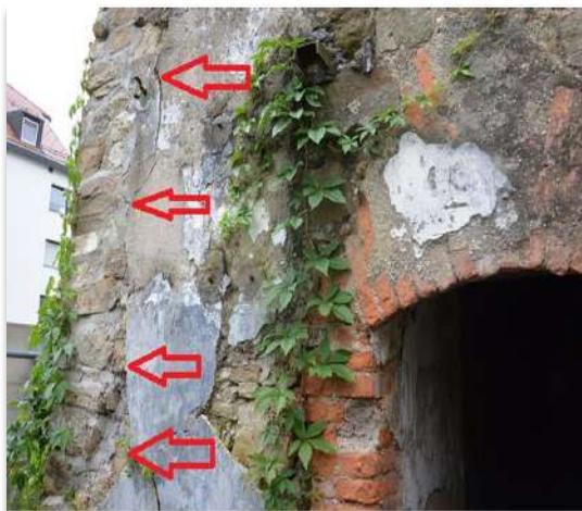
Slika 1: Pred leti saniran izpadli vogal zidu pritličja na SV vogalu stolpa
