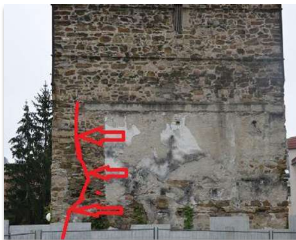
Slika 2: Saniran vogal na SV vogalu stolpa
