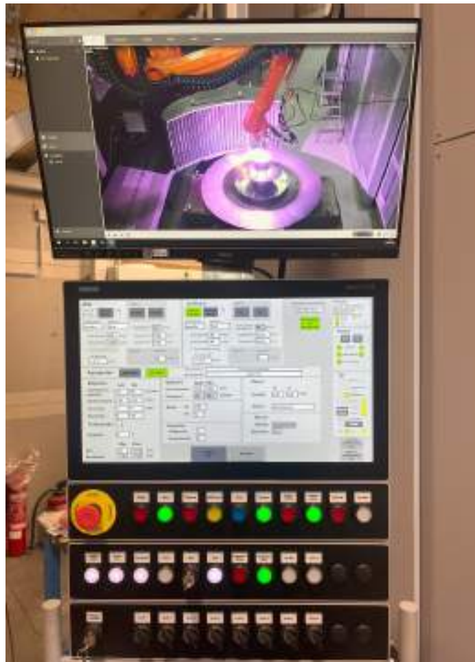
SLIKA 42: POGLED NADZORNEGA PANELA
