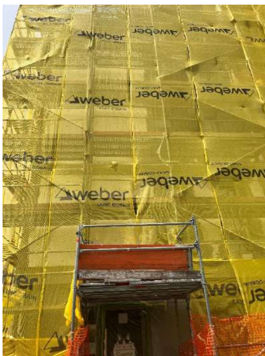
Slika 7 Zavarovanje vhodov v blok
