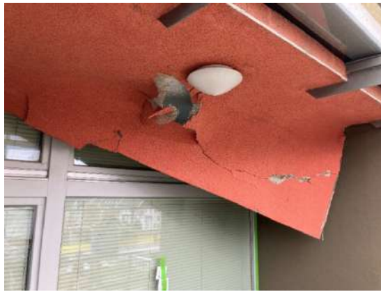
Slika 12 Poškodbe na balkonskem stropu
