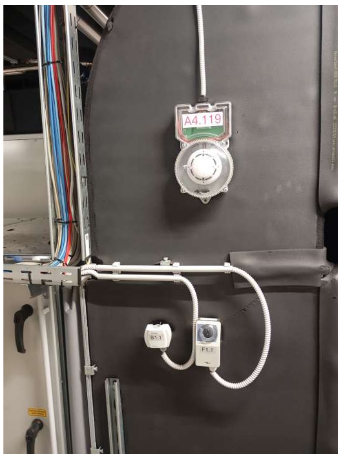
Slika 9: Senzorji za temperaturo, vlago in požarna zaščita
