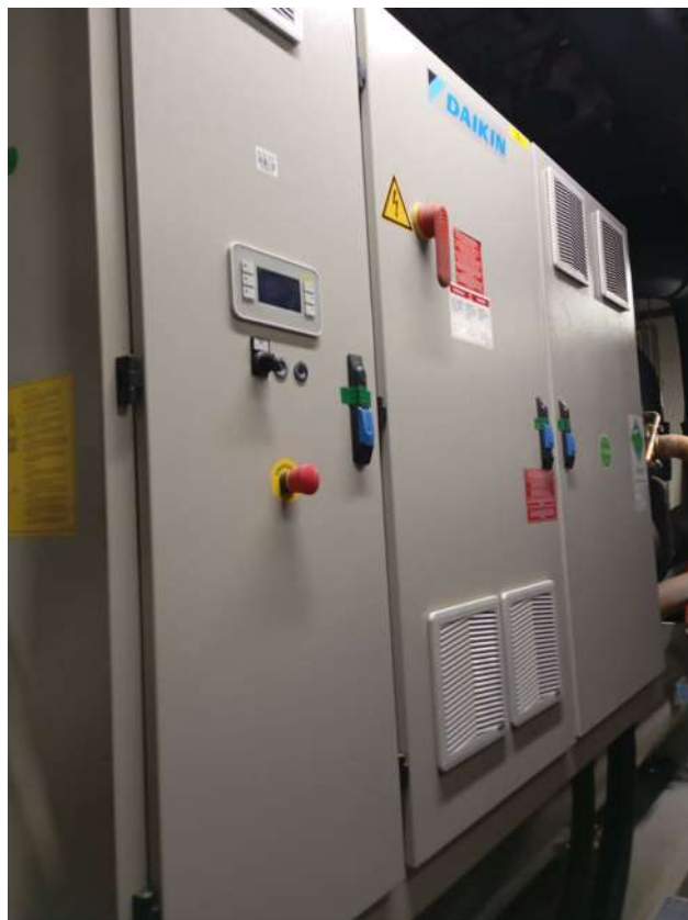
Slika 4: Elektro omara hladilnega agregata
